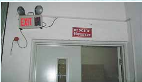
Emergency Light/ Exit Opening Outwards आपातकालीन लाइट / निकास मार्ग
